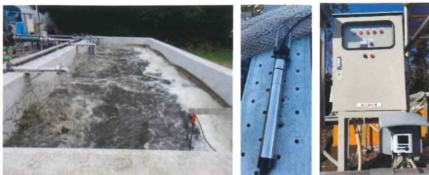
図1 DO制御システム （左：浄化槽、中央：DOセンサー、右：制御装置）
